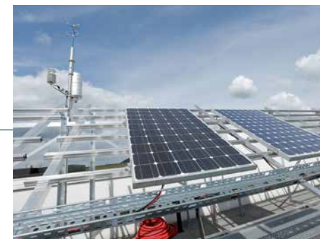
Outdoor Metrologielabo voor Fotovoltaïsche Systemen
